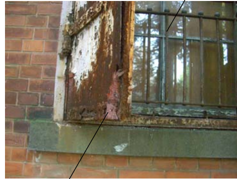
雨戸外側 腐朽状況
