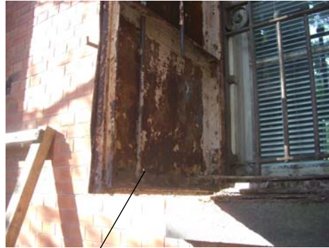
雨戸内側 腐朽状況
