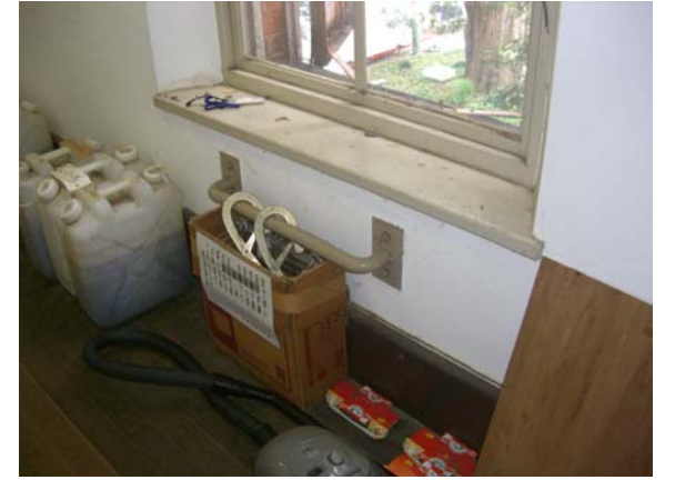
2階 廊下東側 (避難器具)
