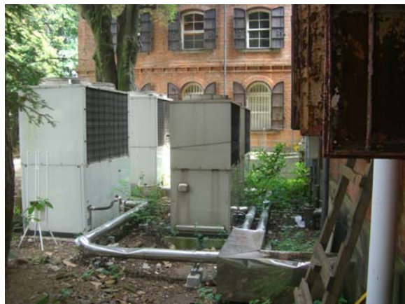
東南外隅（空調屋外機）
